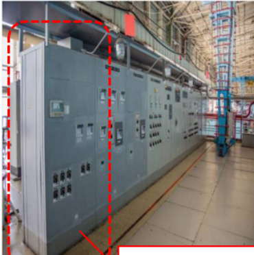
工場内配電盤
