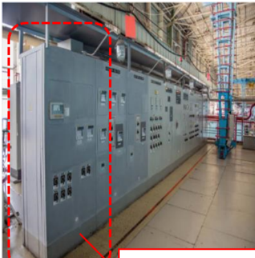
工場内配電盤
