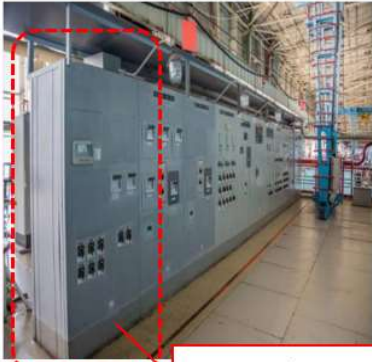
工場内配電盤
