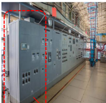
工場内配電盤
